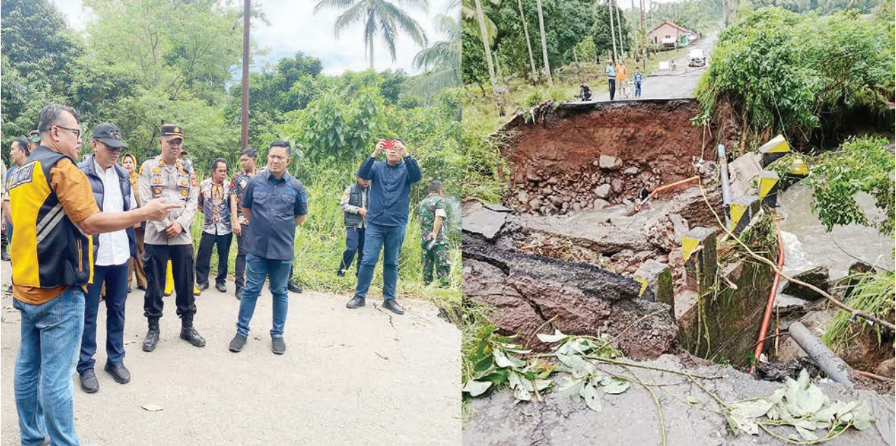
PUTUS : Jalan utama Pendopo Lintang—Kota Pagaralam, tepatnya di perbatasan Desa Seleman Ulu dan Desa Sawah, Kecamatan Muara Pinang, Kabupaten Empat Lawang terputus akibat longsor.
