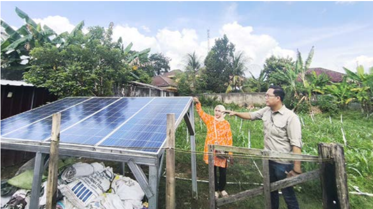
BANTUAN PERTAMINA: PLTS di areal KWT Kemuning menggerakkan mesin air dan penerangan sehingga membantu pertanian warga.
