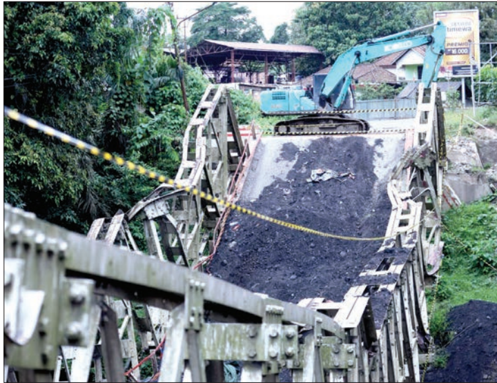
RUSAK: Kondisi Jembatan Muara Lawai di Kecamatan Merapi Timur, Kabupaten Lahat yang roboh dan akan segera diperbaiki.
