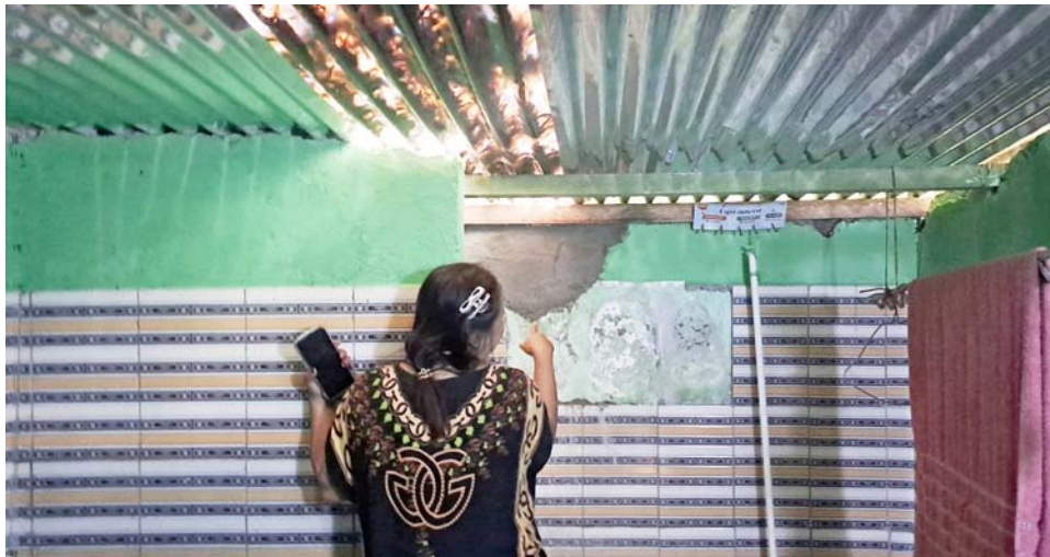
JEBOL DINDING: Elis menunjukkan dinding kamar mandi yang dijebol pelaku pencurian yang menyatroni rumahnya.
